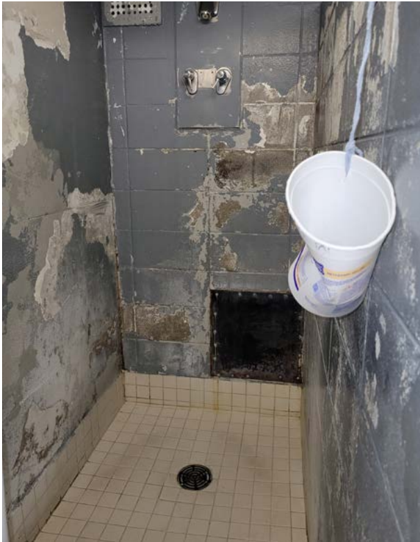
Une douche à l'Établissement de Port Cartier
