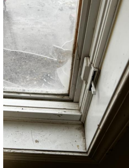
Quincaillerie de fenêtre de mauvaise qualité.
