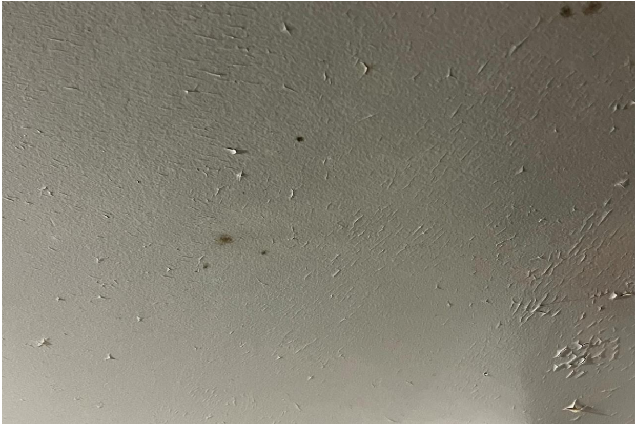
Signes de moisissure dans une salle de bains à Pang.
