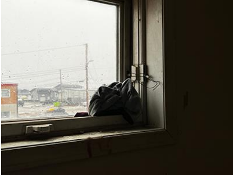
Rankin Inlet: Des vêtements placés dans une fenêtre cassée pour conserver la chaleur.
