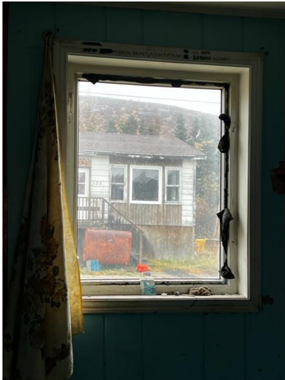
Fenêtres mal scellées.
