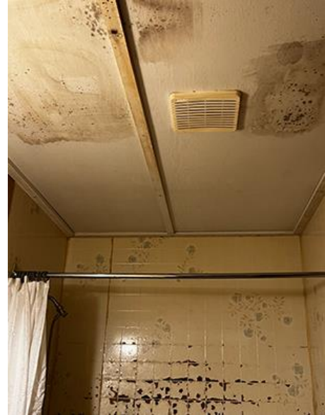
Une salle de bains présente des signes évidents de dégâts d'eau et de moisissure.
