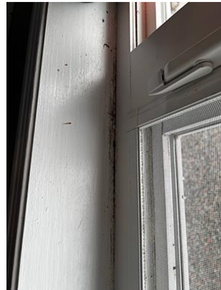
Les encadrements de fenêtres de cette maison sont endommagés par la condensation et la moisissure noire causée par l'humidité ambiante.
