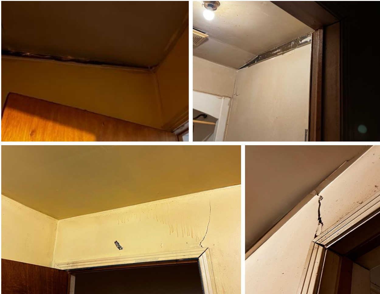
Les maisons moisies et l'instabilité du logement.
