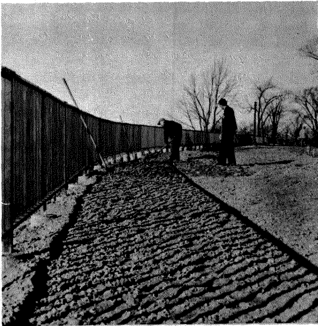
Au cours de l'hiver, la CCN a construit une nouvelle clôture en fer forgé au parc Major et y a changé l'alignement de quelques sentiers.
