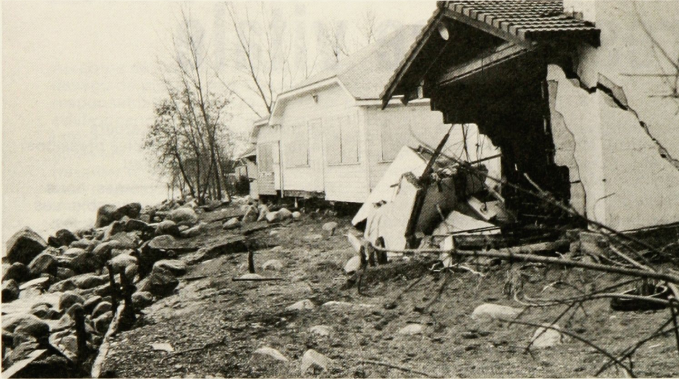
Des dommages considérables aux propriétés riveraines peuvent survenir lorsqu'une alimentation constamment élevée affecte le niveau d'un bassin d'eau.
