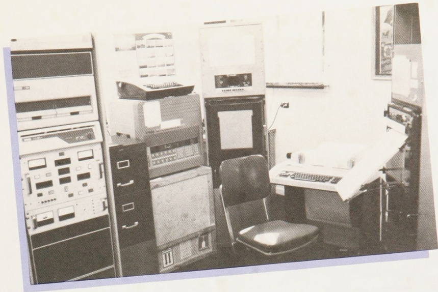
Intérieur du conteneur de l'équipement PASA
