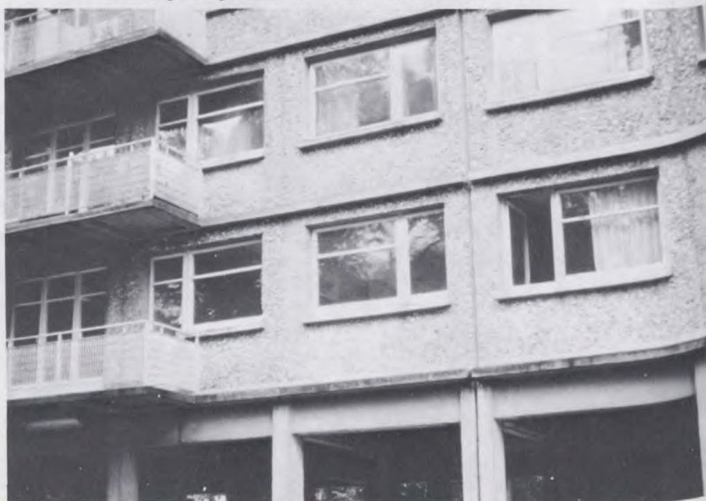
Quartier général du SHAPÉ construit il y a 20 ans près de Paris. L'immeuble est encore en excellent état.
