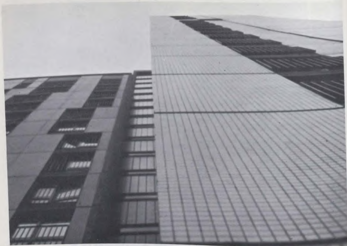
Carreaux de céramique de 2"x2" sur panneaux-façade
