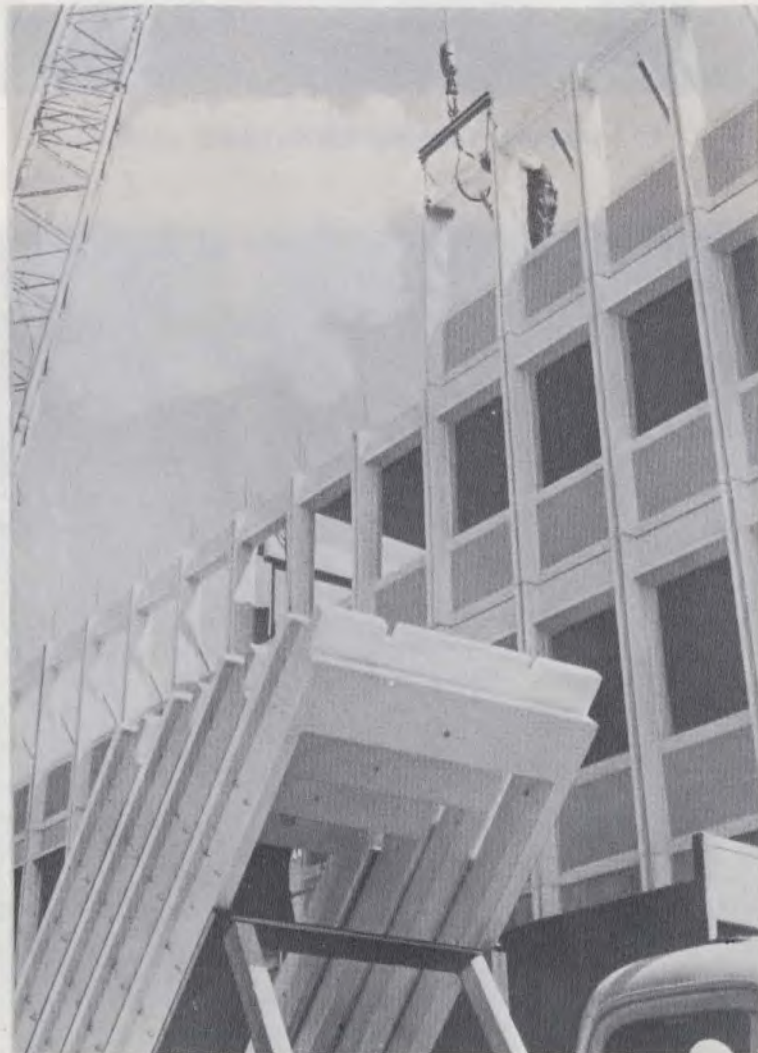
Unité Laingwall que la grue a prise sur la remorque et déposée à sa place définitive. Les planchers pré-coulés servent de plateforme de travail
