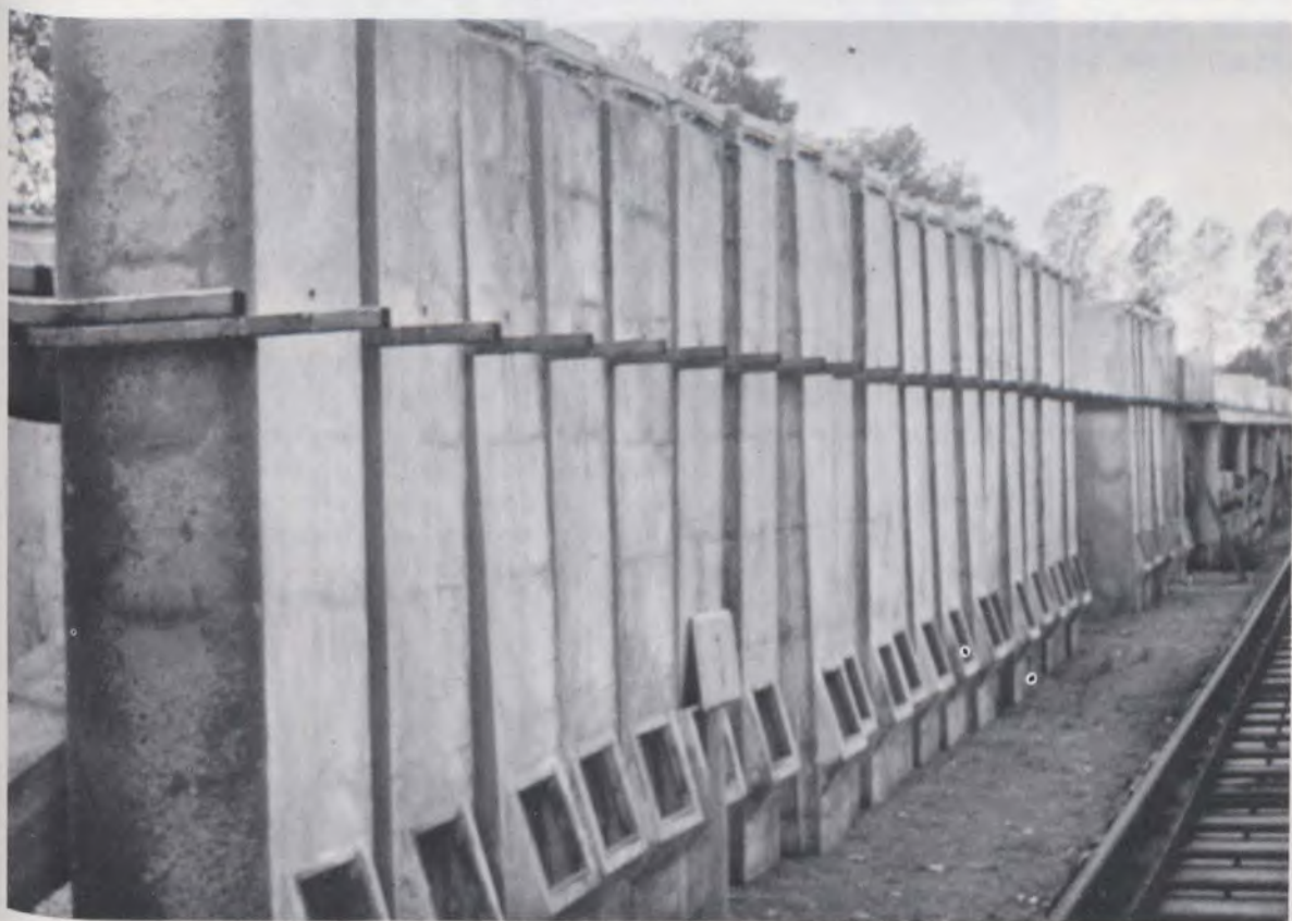
Descente à déchets
