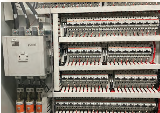
Panneau chauffant de dégivrage montrant les disjoncteurs.
