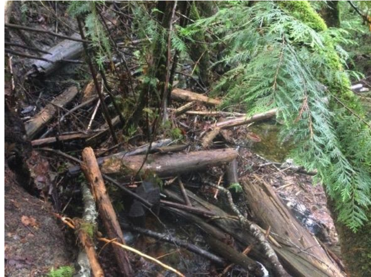
2.) Wolf Creek culvert log Jam
