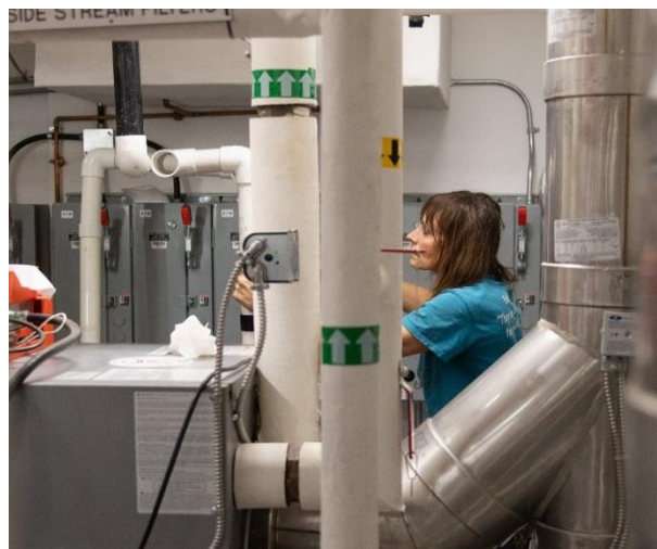
Photo 9 : Mise en service du système de traitement bioélectrochimique anaérobie des eaux usées dans un triplex à la Station canadienne de recherche dans l'Extrême-Arctique
