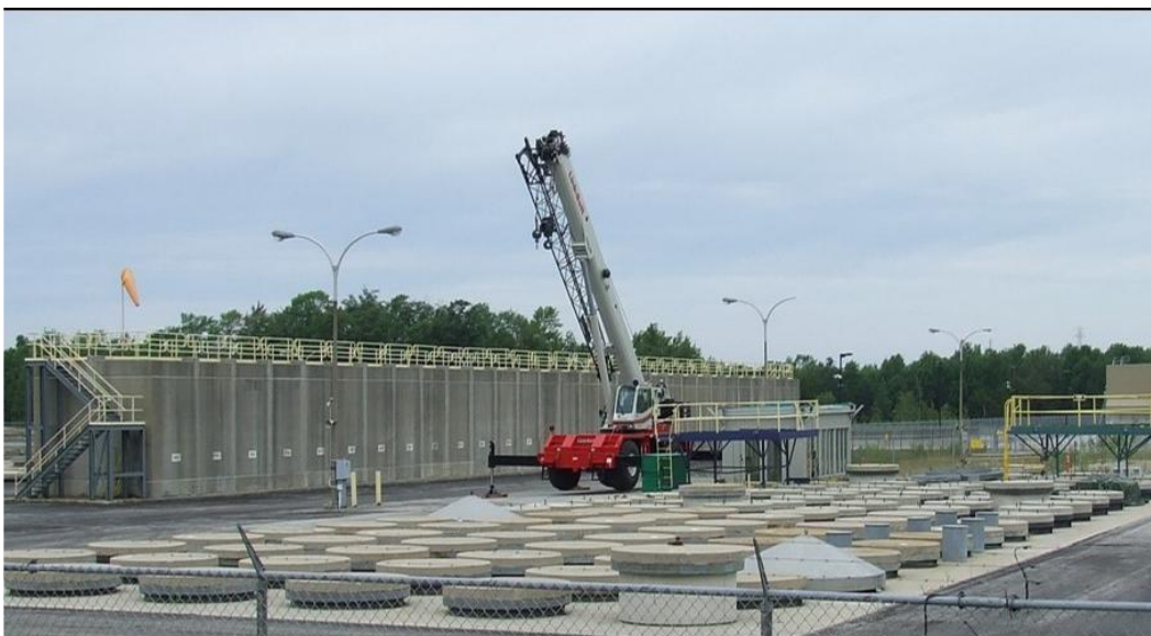
Figure 5.32 : Structures d'entreposage souterraines destinées aux DRMA à l'IGD Western
