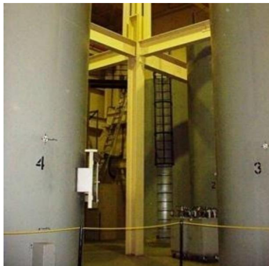
Figure 4.8 : Vue interne de l'entreposage du combustible à Gentilly-1
