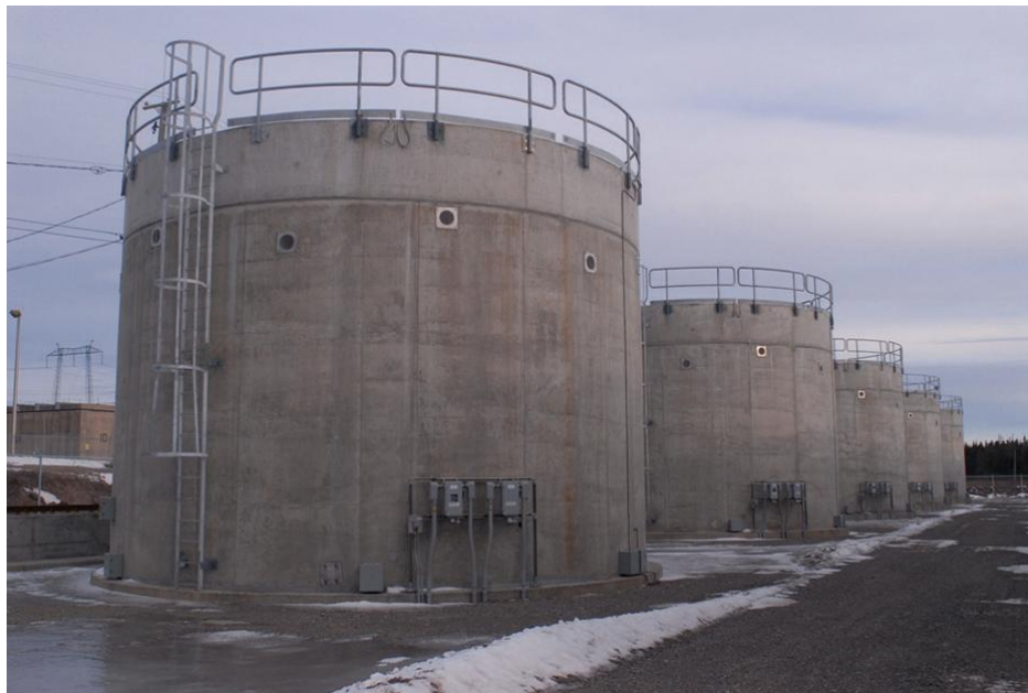
Figure 5.26 : Silos destinés aux déchets de retubage de Point Lepreau
