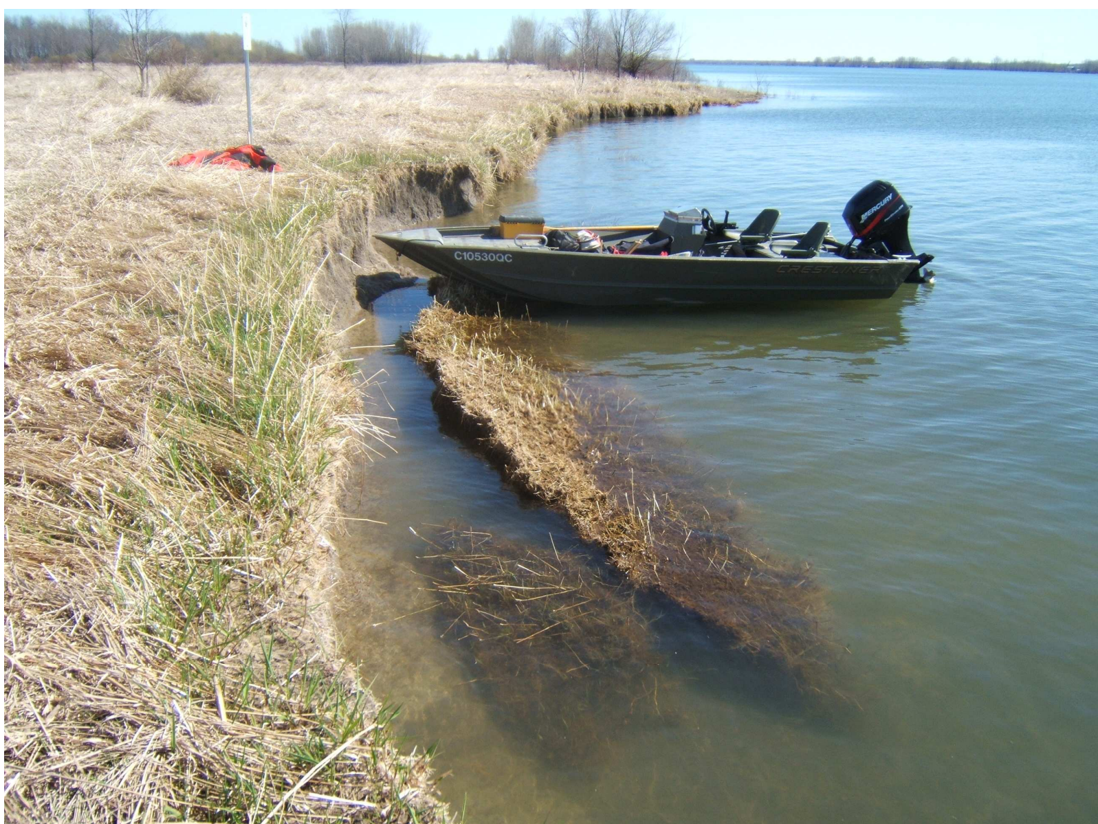
Photo 1 Station de Verchères montrant les structures effondrées au printemps.
