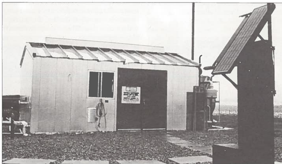
Un appareil SCADA placé à côté d'un compresseur de gaz naturel à l'un des emplacements d'Ainsworth Remote Inc.
