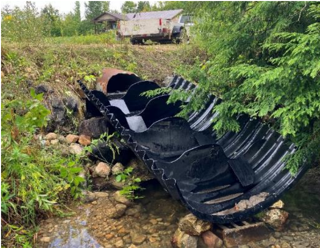
Figure 1. Exemple de couloir pour poissons Fishculvert en acier galvanisé à revêtement polymère, muni de déflecteurs, installé à un ponceau sur surplomb afin de rétablir le passage des poissons.
