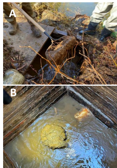
Figure 1. Racines de thuya (A) dans la chambre d'admission et (B) remontant dans les conduites, empêchant l'écoulement de l'eau.
