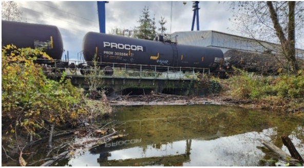
Figure 5. Débris ligneux à la base d'un pont ferroviaire dans le ruisseau Mackay, C.-B. Une accumulation supplémentaire pourrait nécessiter le retrait du bois.
