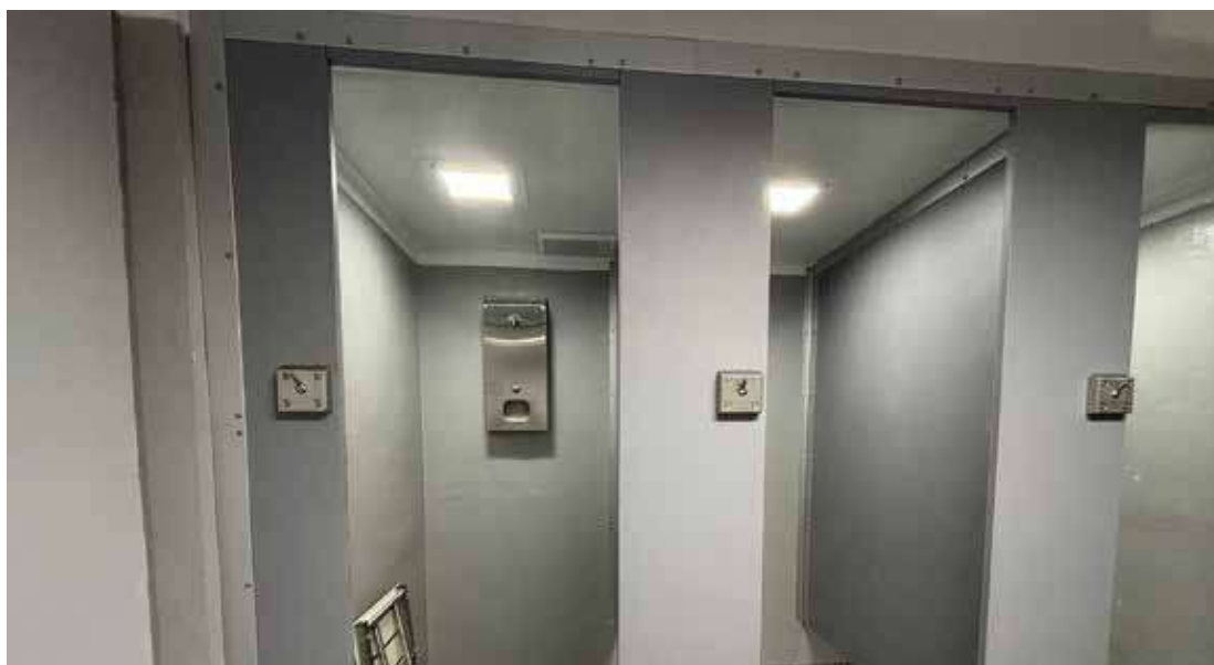
Établissement de Cowansville, au Québec – Crochets de douche pliables et pommeau de douche conçus pour prévenir l'utilisation à des fins de tentatives de strangulation
