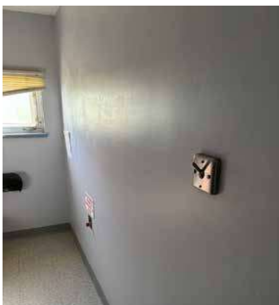
Établissement Nova pour femmes, en Nouvelle-Écosse – Crochet repliable conçu pour empêcher toute utilisation à des fins de tentatives de strangulation
