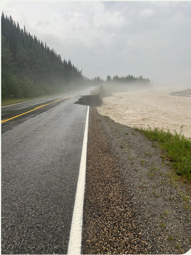
Portion de la route de l'Alaska emportée par les eaux à l'été 2024.
