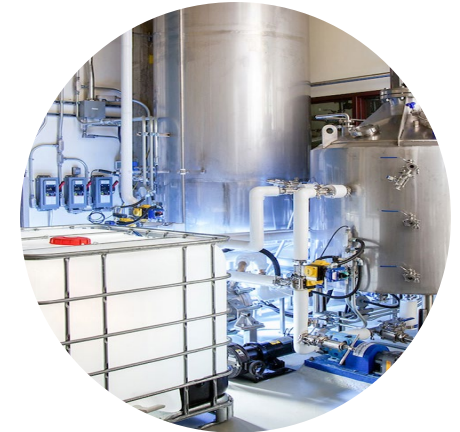
Usine pilote de biotransformation anaérobie du campus de Royalmount
