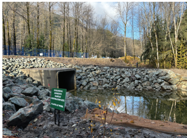
Des mises à niveau des dalots restaurent l'échange maréal côtier naturel entre la rivière, l'estuaire et l'océan, même à marée basse ou pendant les périodes de débit minimal. (Photo par Sydney Bryce, MPO)
