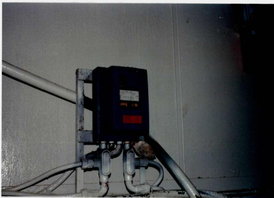
Emplacement de la lecture du pourcentage de débit du débitmètre magnétique du point 1.
