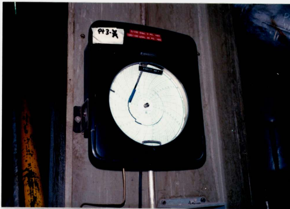
Appareil de mesures du débit
