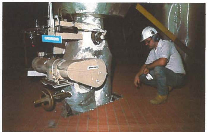
Valve de contrôle du dispositif d'alimentation pour les installations de grillage.
