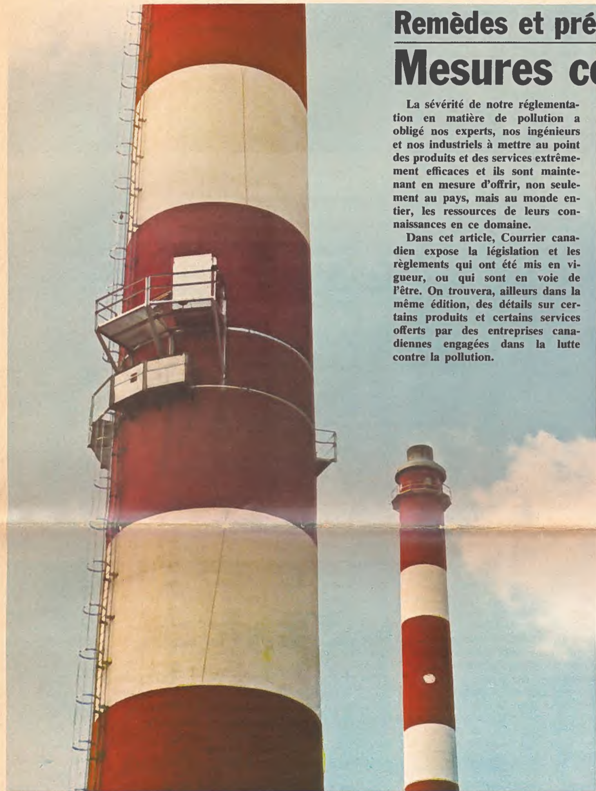
Ce dispositif intercepte de façon continue les émissions polluantes à la sortie d'une cheminée. Ce travail est une spécialité de la firme Western Research & Development.
