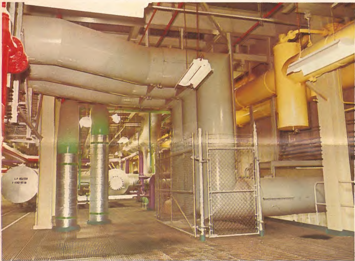
Cette barre omnibus à phases isolées, à refroidissement forcé, fabriquée par I.T.E. transmet l'électricité de la génératrice aux transformateurs, à la centrale thermonucléaire de l'Ontario-Hydro, à Pickering. La barre à phases isolées, en usage dans le monde entier, a été mise au point et fabriquée par I-T-E Circuit Breaker (Canada) Limited, de Mississauga (Ontario).
