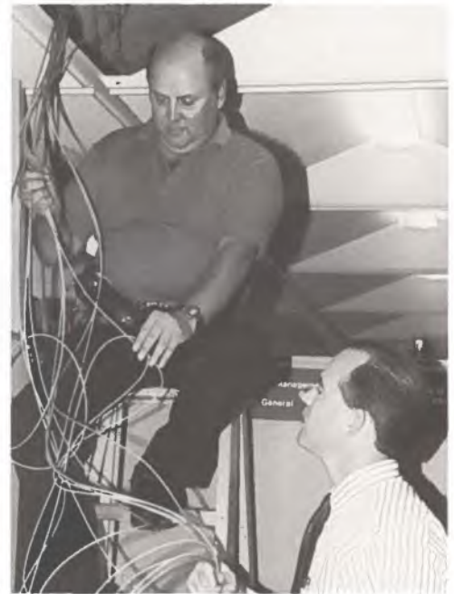
Inspection du câblage : Bert Bray de TPC (sur l'échelle), et John Powell , agent des opérations à la DGSA.
