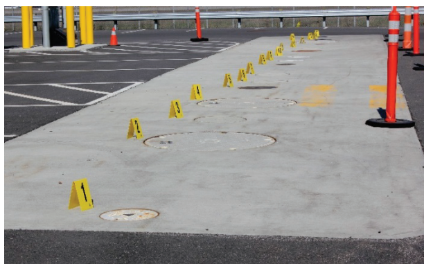
Image 1 : Aperçu des différentes bouches d'égout sur le site de déversement
