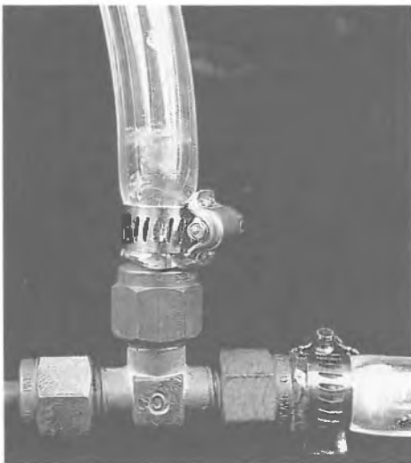
Figure 1. Produits de corrosion de couleur verte au point où un tube de polychlorure de vinyle plastifié (Tygon) est fixé à une garniture de cuivre.
