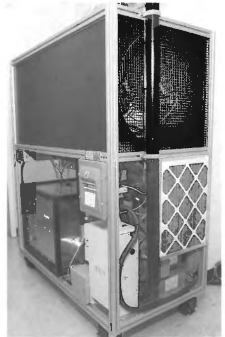
Figure 4. Appareil de régulation de l'HR n° 2, installé au Musée des sciences et de la technologie du Canada. L'appareil qui alimente en air l'aire d'exposition principale du musée est situé dans un ancien coin cuisine de petites dimensions.
